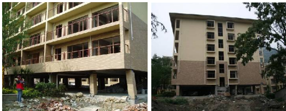
(a) 震害情况
