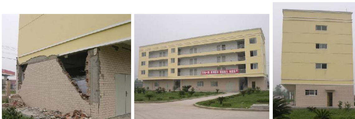
(i)填充墙平面内不均匀布置造成平面刚度偏心, 产生扭转地震响应的破坏
