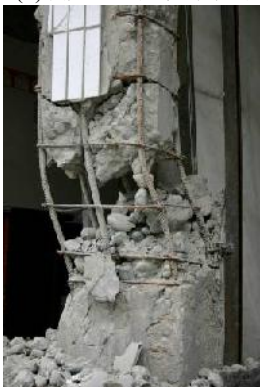
(d) 框架柱剪切破坏
