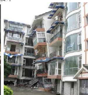
(h) 底层坍塌
