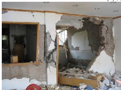
(b) 填充墙造成框架柱形成短柱剪切破坏
