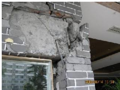
(f) 梁柱节点区破坏
