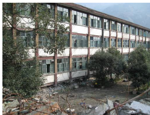
(d) 映秀镇某宿舍底层倒塌 (d) Collapse of the first story of a dorm building
