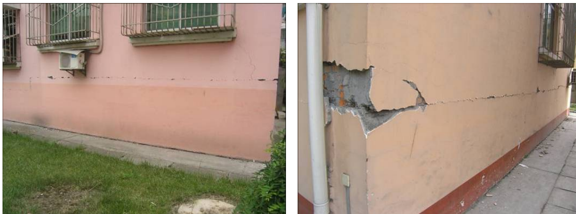
图1 汶川地震中绵竹某砌体结构房屋的底部水平裂缝(李爱群)
