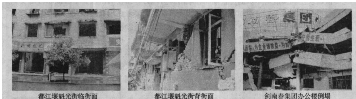
图7 水平混合框架—砖混结构的震害
