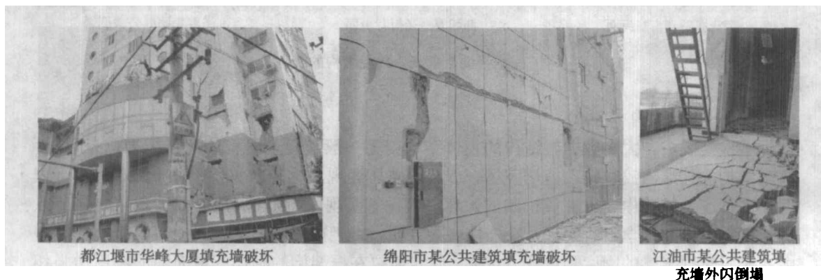
图9 框架结构的非结构构件破坏
